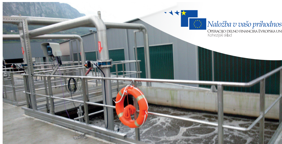
Aeracijski bazen Nove čistilne naprave Vipava
